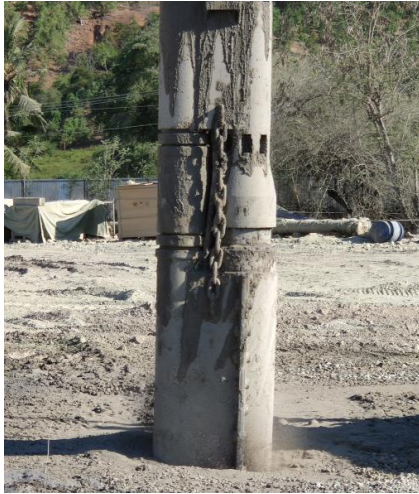
图 14 下料管道系统 Fig. 14 Feeding system
