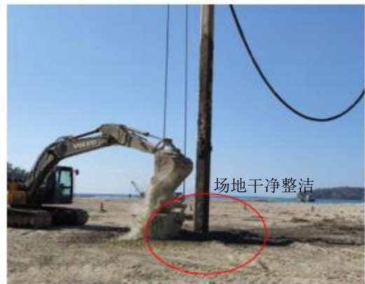
图 17 底部出料振冲法施工现场 Fig. 17 Construction site of bottom feed vibroflotation
