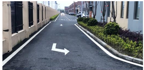
(b) 2020 年 3 月 9 日拍摄无可见裂缝, 仅见表层沥青缺失形成零碎凹坑
