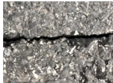
(b) 某处沥青路面T型交接处开裂
