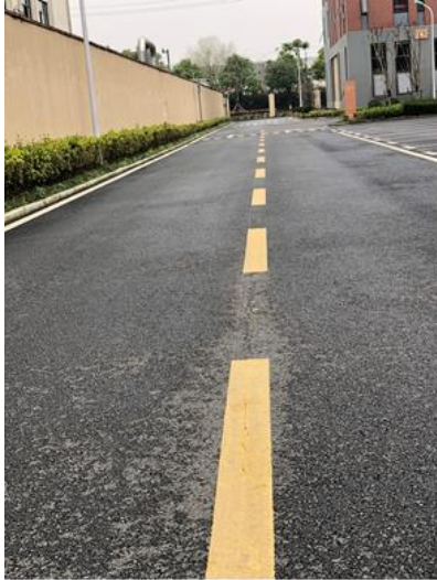
图 13 35 号楼南侧道路裂缝图
