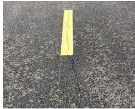
(a) 某处沥青路面中心线开裂
