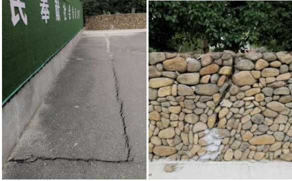
图 4 南侧道路及挡墙裂缝
