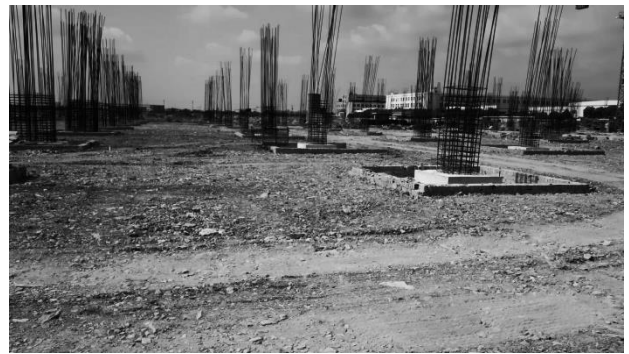
图3 地基加固前工程现状图
