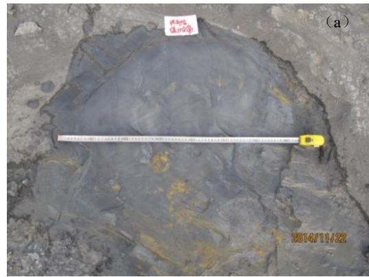
1号试验点: 泥页岩, 灰黑色, 层理发育, 缓倾角, 层面产状 181^{\circ} \angle 16^{\circ} 。发育 1 组裂隙, 与层面正交。
