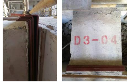
图8 支墩与内圈梁间隙
