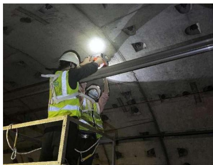
图 5 结构病害检测图
