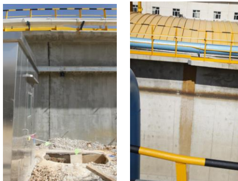
图2 中和池池壁开裂情况
