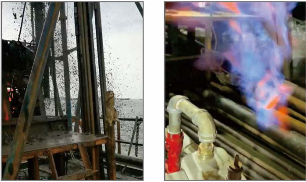
图2 现场遭遇浅层气喷发和燃烧情况
