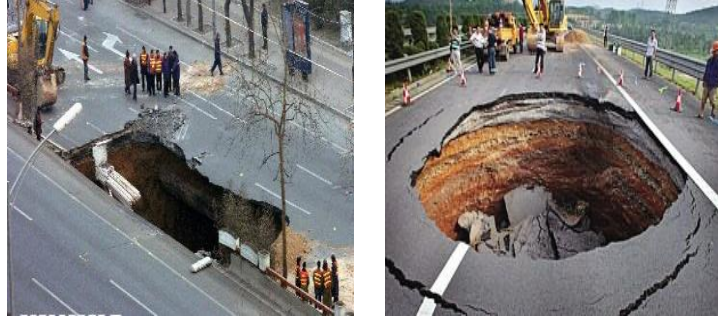
a) 沟渠型塌陷
