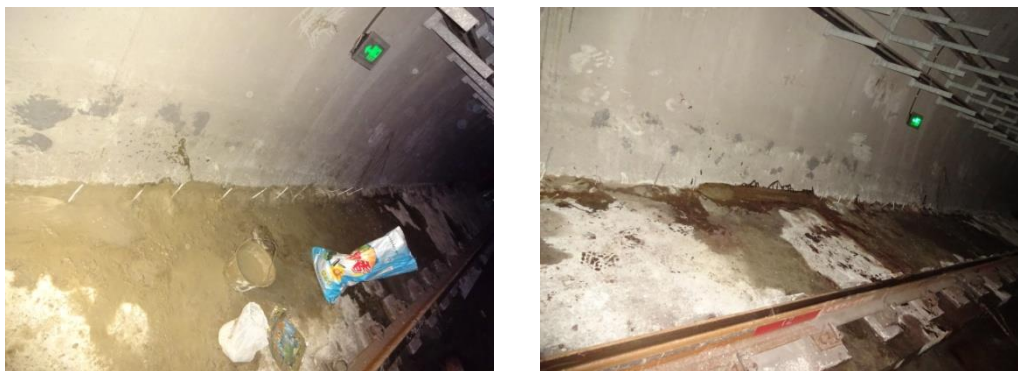
图4 道床翻浆冒泥情况
