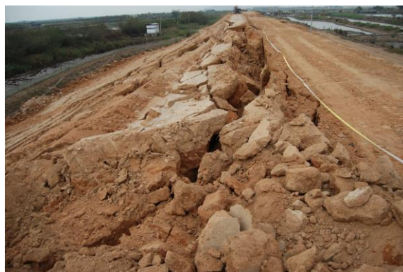
(b) 旋喷桩复合地基路堤施工期发生滑移
