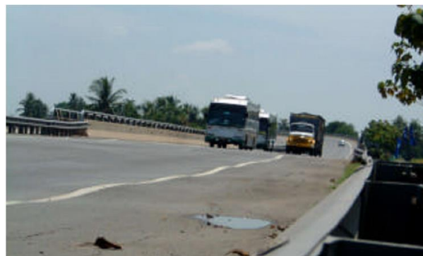
(a) 路面出现不均匀沉降
