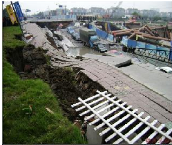
图2 杭州某地铁塌方
