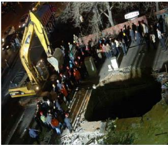
图1 海淀区某地铁塌方
