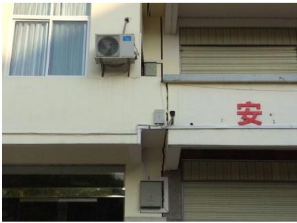
图3 南侧住宅楼开裂图
