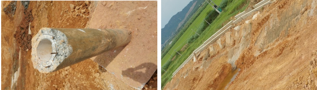
(a) 弯断的管桩
