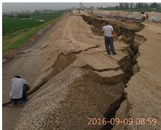
图 15 路基滑塌照片
