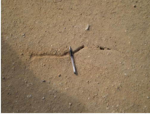
图 4 距边坡后缘 40m 处的裂缝
