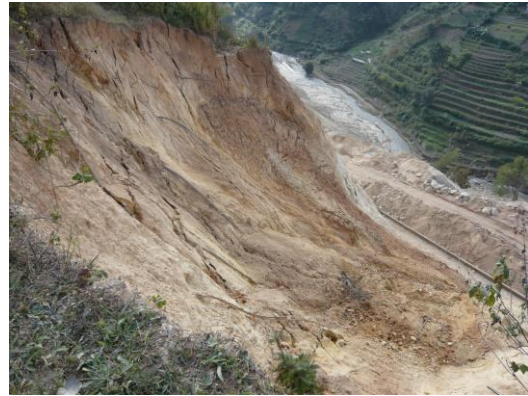
图 2 滑坡后部坡面凹槽
