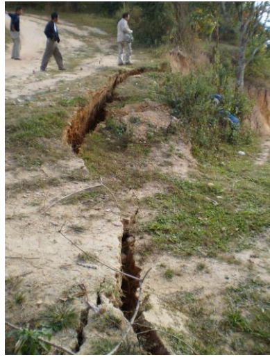
图 5 边坡后缘次级滑体与裂缝
