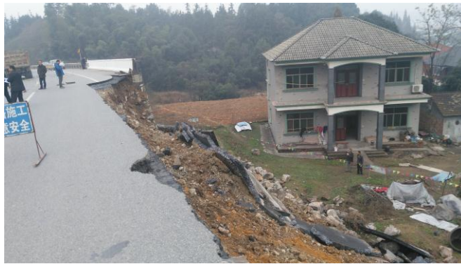
图 1 挡墙坍塌后现场
