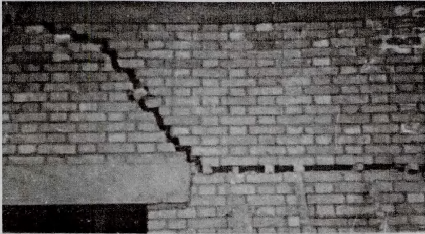
a 地基加固前裂缝宽 10~120mm, 长 1~3m
