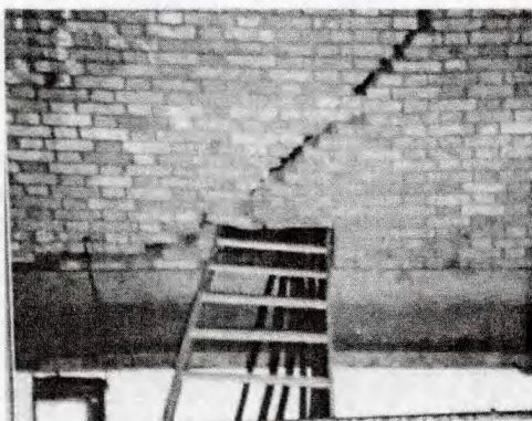
图 1 熄焦泵房结构墙体开裂, 呈斜向延伸 10~120mm 长度达 1.0~3.0m
