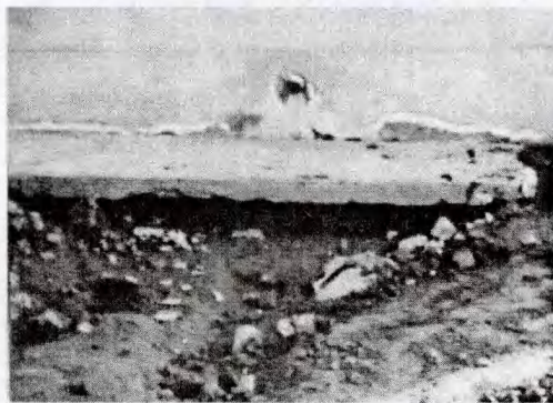
图 3 清水泵房墙周围地面开裂, 缝宽 15~60mm 长 3~4m, 地圈梁下陷成洞高 0.4m 实况
