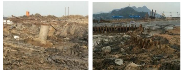
图 7 深厚软基未处理就桩基施工导致失败的案例图
