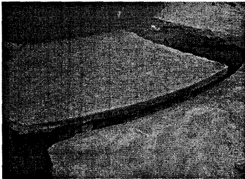
图6 顶升施压地面散水被顶起实况
