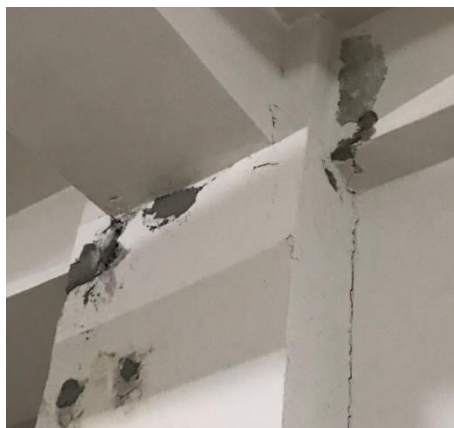
图2 梁柱节点开裂
