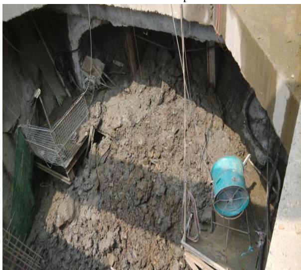
图 6 地道暗挖坍塌后明挖竖井堆积示意图
