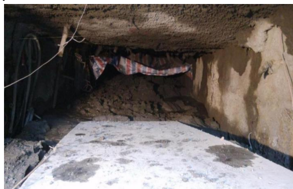
图 7 二次坍塌后掌子面实况
