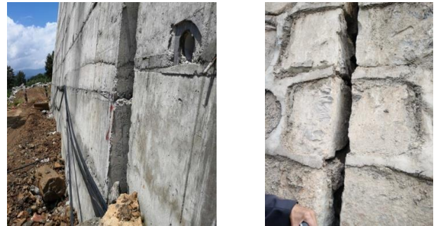
图 2 路堤墙基础和路堤墙伸缩缝变形
