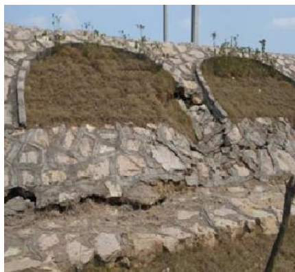
(b) 某高铁地基沉降导致开裂
