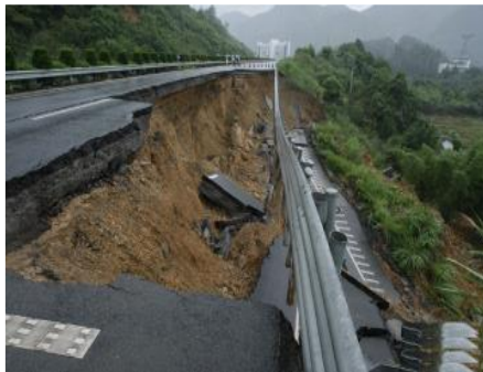
(a) 某高速公路路堤失稳破坏
