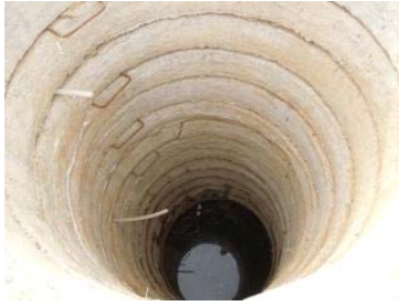
图 20 地下水监测用井 Fig. 20 Groundwater monitoring well
