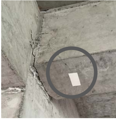
图 12 加固后裂缝区域
