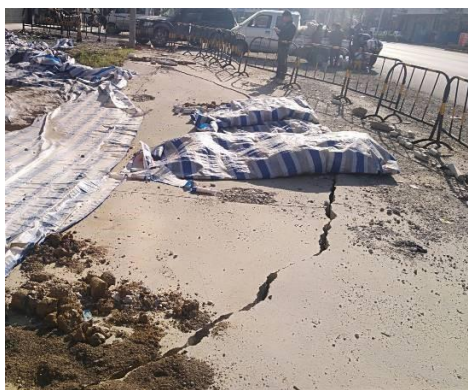
图1 施工前混凝土路面塌陷照片
