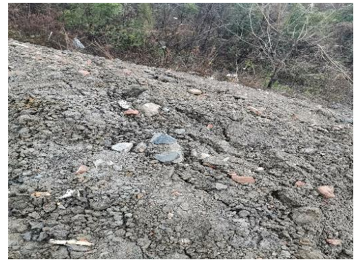
图2 边坡坡顶蠕动变形
